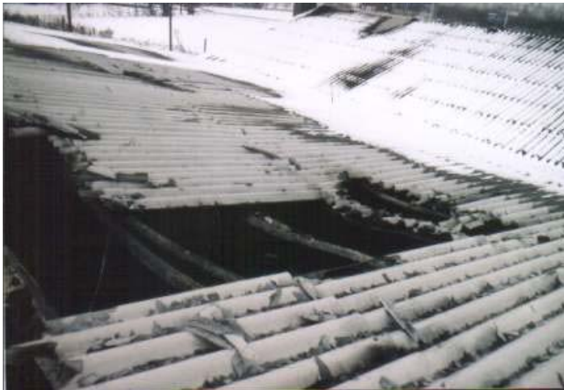
Toiture de la salle 6, détruite par l'incendie de 1980
